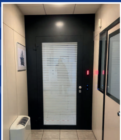
PORTE DI SICUREZZA CON CONTROLLO ACCESSI
